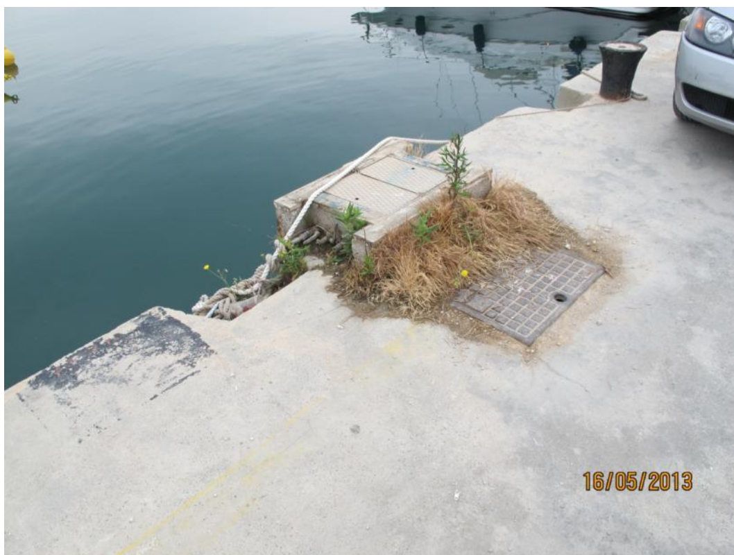
Φωτ. 9: Φθορές στα κρηπιδώματα και στις Η/Μ υποδομές.
