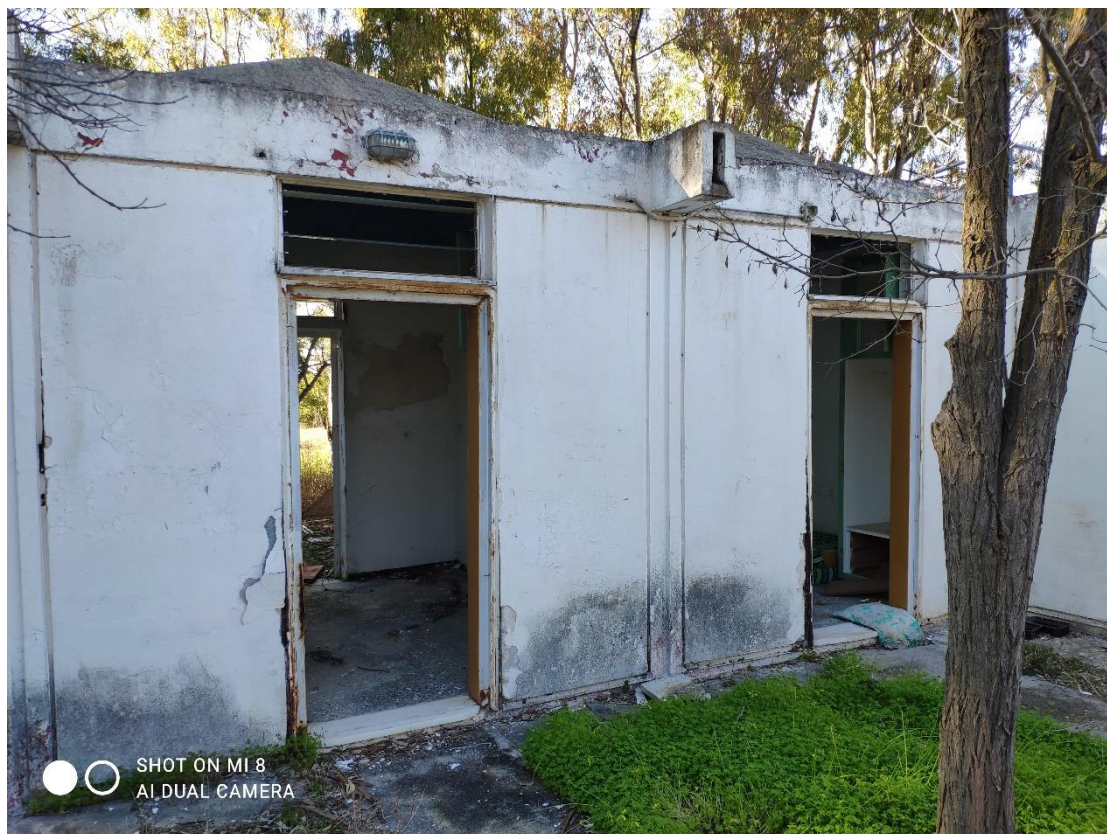
Εικόνα 5.2-1 Κατάρρευση κτιρίων camping μετά από βανδαλισμούς και την εγκατάλειψη
